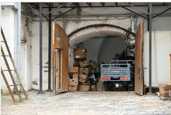
Otvorený nakladací priestor s nedostatočným tesnením
