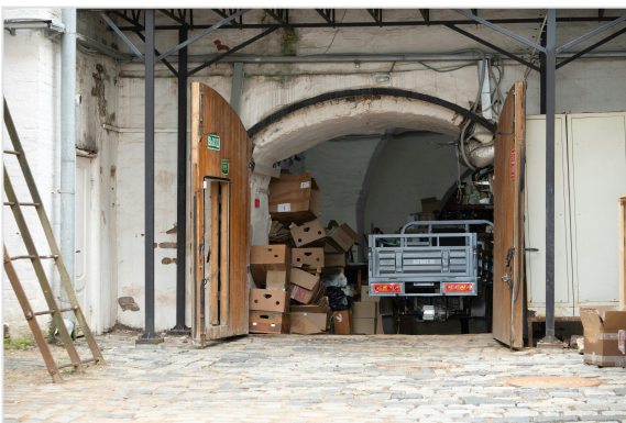
Otevřený nakládací prostor s nedostatečným těsněním
